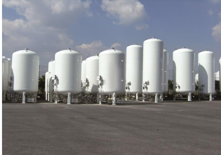
Figura 5: Tanques Criogênicos (VRV).
