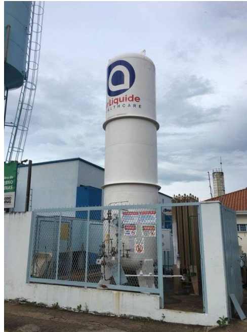
Figura 2: Instalação de tanque criogênico estacionário (Santa Casa de São Sebastião do Paraíso, 2018).
